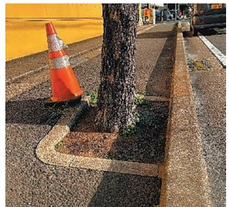
コンクリートが盛り上がっている
