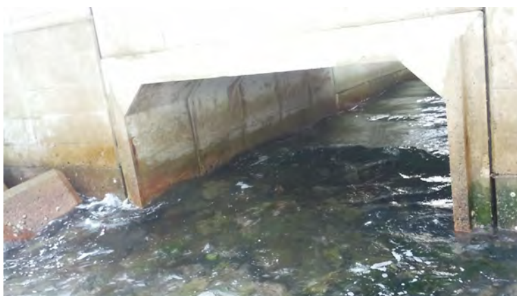
浮遊物対策用スクリーンがない
