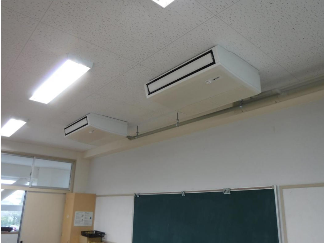
(全小中学校 空調設備設置)
